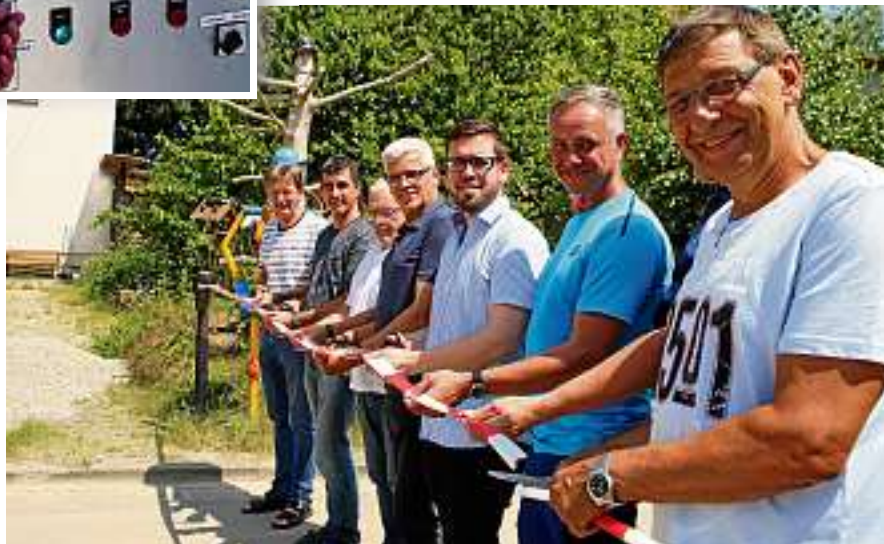
Der Kanalbau in Selka steht vor dem Abschluss. Die Pumpstation ist in Betrieb genommen, die Straße freigegeben. Jetzt müssen nur noch die Hausanschlüsse gelegt werden. Foto: Jana Borath
