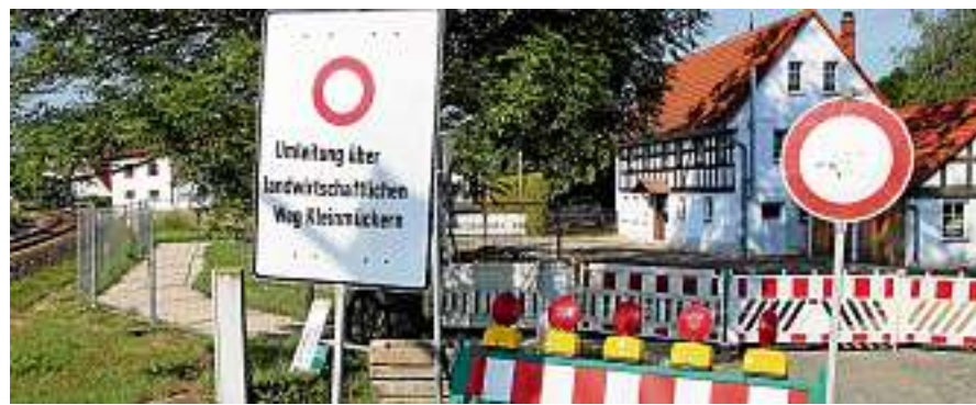
Ein Teil der Häuser und Grundstücke ist nur über den landwirtschaftlichen Weg nach Kleinmückern erreichbar. Fotos (2): Jana Borath
