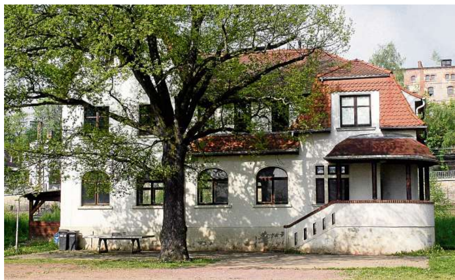
Der Jugendheim Gößnitz in einer Aufnahme aus besseren Tagen. Aktuell ist der Keller feucht, im Außenbereich sorgt Müll für Ärger. ARCHIVFOTO: PETRA LOWE
