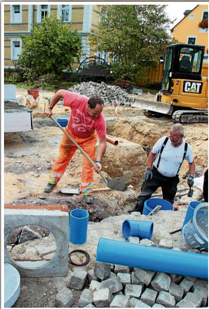
Thomas Gerth (rechts) richtet die Regenwasser-Einläufe ein, Carsten Rückrod schaufelt ihm den Beton dazu.
